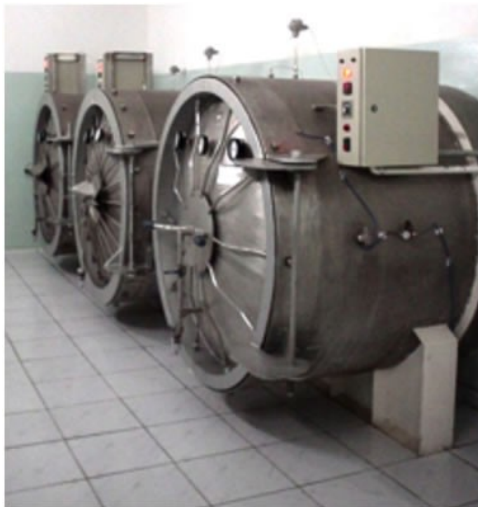
Figura 7 - Camara de óxido de etileno
